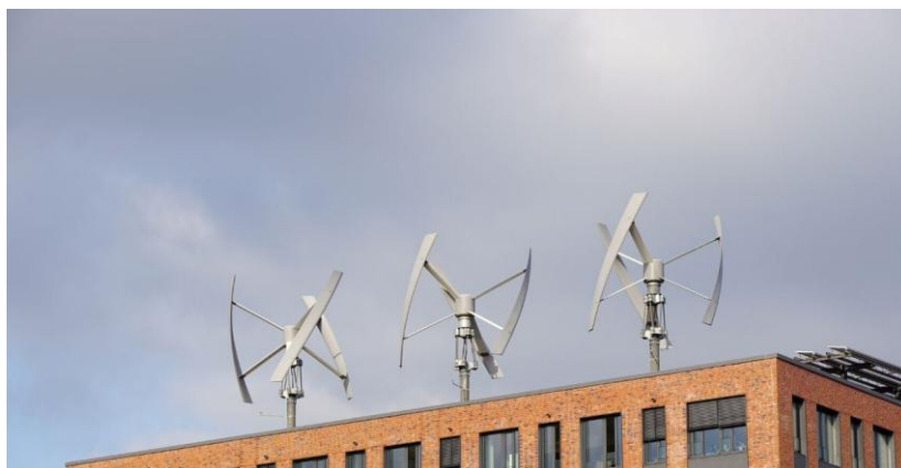
6. ábra: Függőleges tengelyű szélturbina lapostetőn létesítve (Forrás: https://www.attainablehome.com/do-rooftop-small-wind-turbines-make-sense/ )
